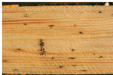
> Holzverfärbungen nach Nutzholzbohrerbefall.
